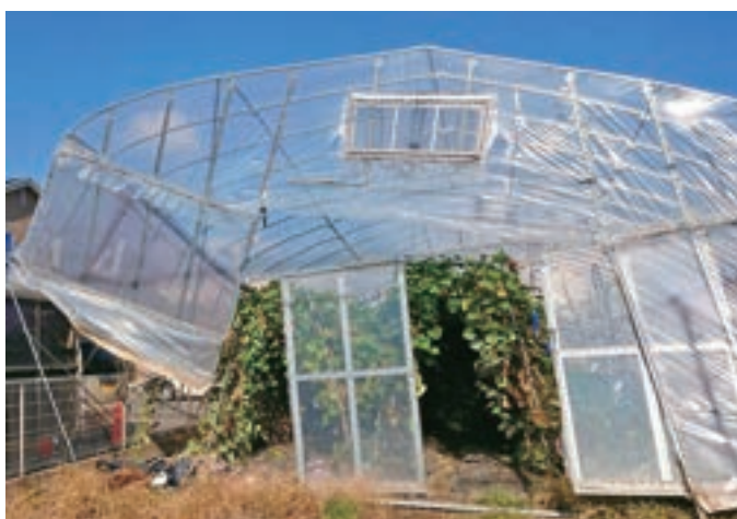
▲ 被害事例① 台風によるハウス破損(風の吹き込み)
